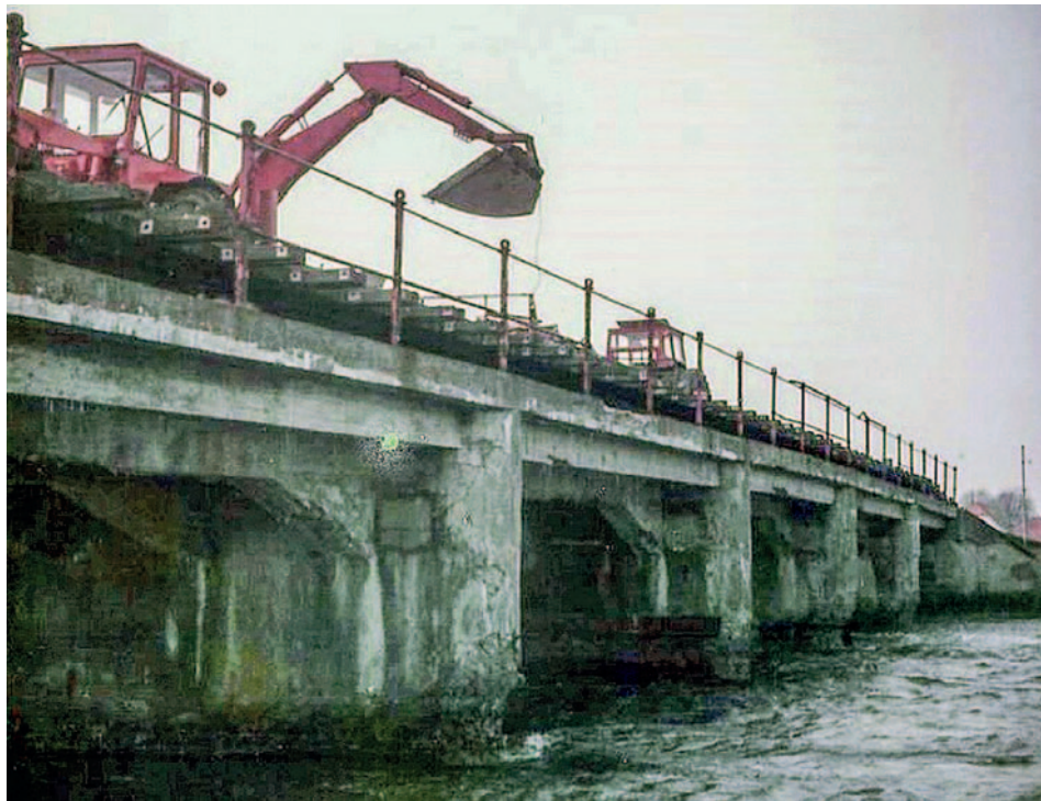
Broen blev bygget i 1933. På dette tidspunkt vidste man ikke, at beton kunne opløses indefra under uheldige betingelser. Den blev en af landets mest nedbrudte broer, og da der i 1964 var uenighed om en ny bro, opførtes en midlertidig nødbro oven på betonbroen. Den ensporede træbro reguleredes med et lyssignal. Nødbroen fjernedes først i 1980.
